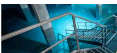
Trinkwasseranlagen wie der Hochbehälter in Schmalegg der TWS Netz sichern die Versorgung.
